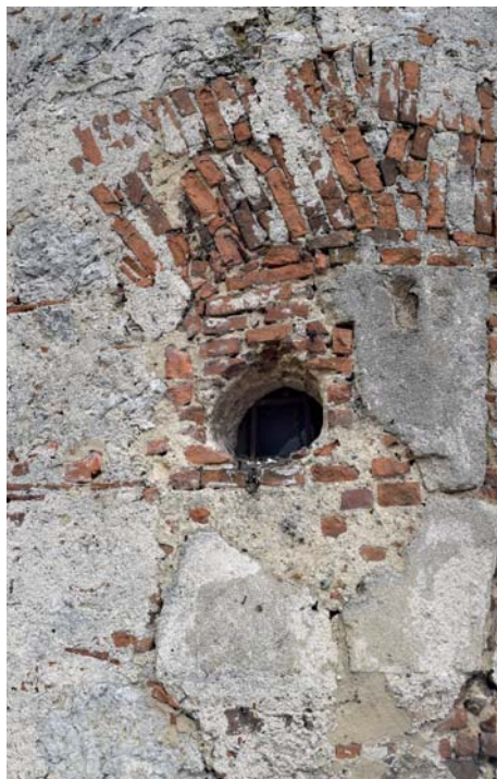
Detail větší kamenné klíčové střílny sestavené ze čtyř opravených kusů. Dle průměru průstřelnice byla určena pro palnou zbraň větší ráže, sloužící k postřelování příjezdové cesty k předhradí. (foto Pavel Borský, 2019)
