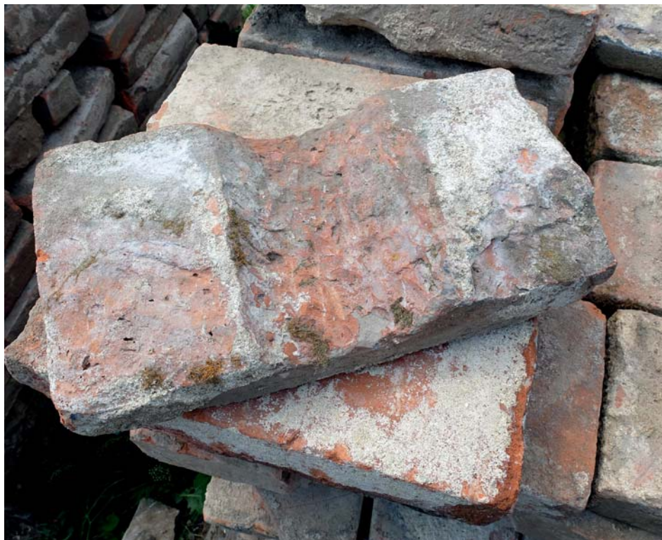
Otesané korytko překladové cihly odvodňovacího otvoru mostovky (foto Petr Holub)
